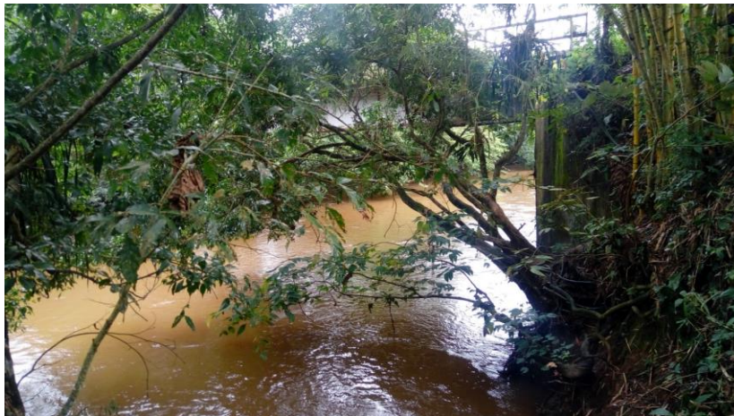
Figura 89. Socavación lateral del río San Pedro en el municipio de Albania
