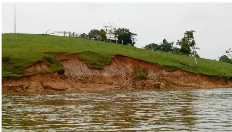
Figura 80. Socavación lateral del río Caquetá el municipio de Curillo
