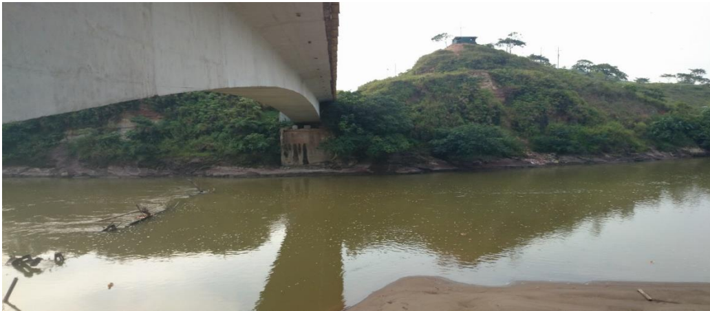
Figura 78. Socavación lateral del río Pescado en el municipio de Valparaíso
